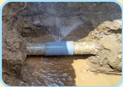
古い水道管継手からの漏水
