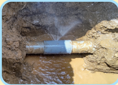
古い水道管継手からの漏水
