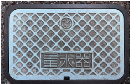
↑メーターボックス（外観）
